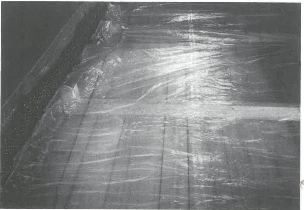
Abb 6: Parkwand aus Bohlen mit Folienabklebung und Abdichtung durch Sandschüttung auf dem Hallenboden
